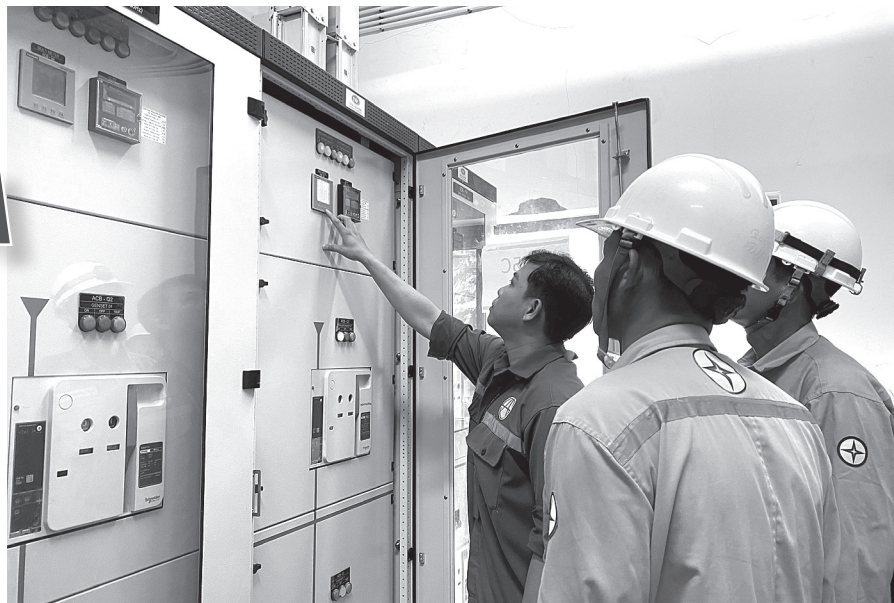
Công nhân Điện lực Đông Hòa hỗ trợ kiểm tra các thông số vận hành tại Phòng Điều khiển hệ thống điện trung tâm Công ty CP Asta Healthcare USA. Ảnh: THỦY TIẾN
