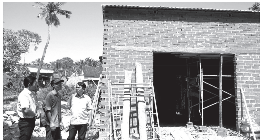
Ông Nguyễn Văn Minh (thứ hai từ phải qua) ở thôn Thọ Lộc, xã Xuân Bình (TX Sông Cầu) trao đổi với đoàn kiểm tra về tiến độ xây dựng nhà. Ảnh: THÚY HẰNG
