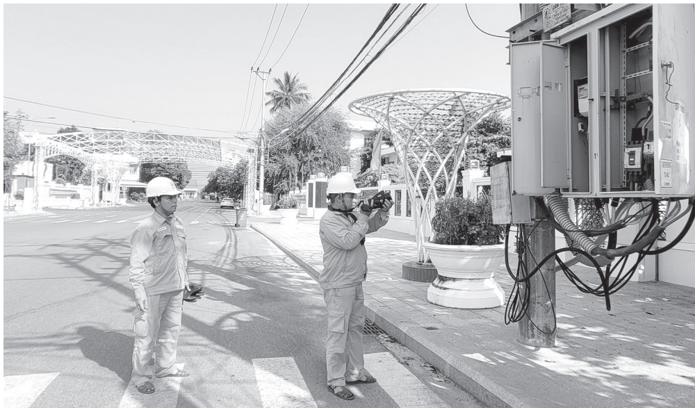
Công nhân sử dụng thiết bị đo nhiệt tại các trạm biến áp để phát hiện sớm các vấn đề. Ảnh: THỦY TIỀN
